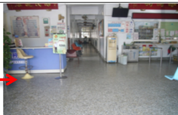
機構入口未加裝 地面標示動線圖
