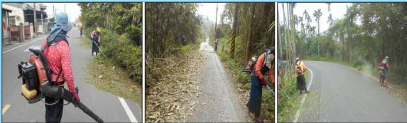
古坑鄉路容維護情形
