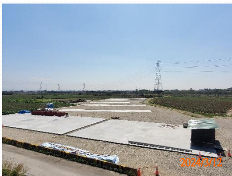
預力I梁場
